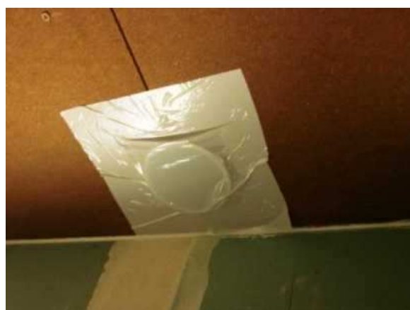
Plafond SDB déposé et refait, étanché par joints d'étanchéité mastic colle : pas de fuite d'air
