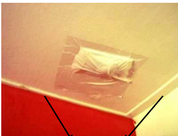
Plafond chambres non traités : fuites d'air !!
